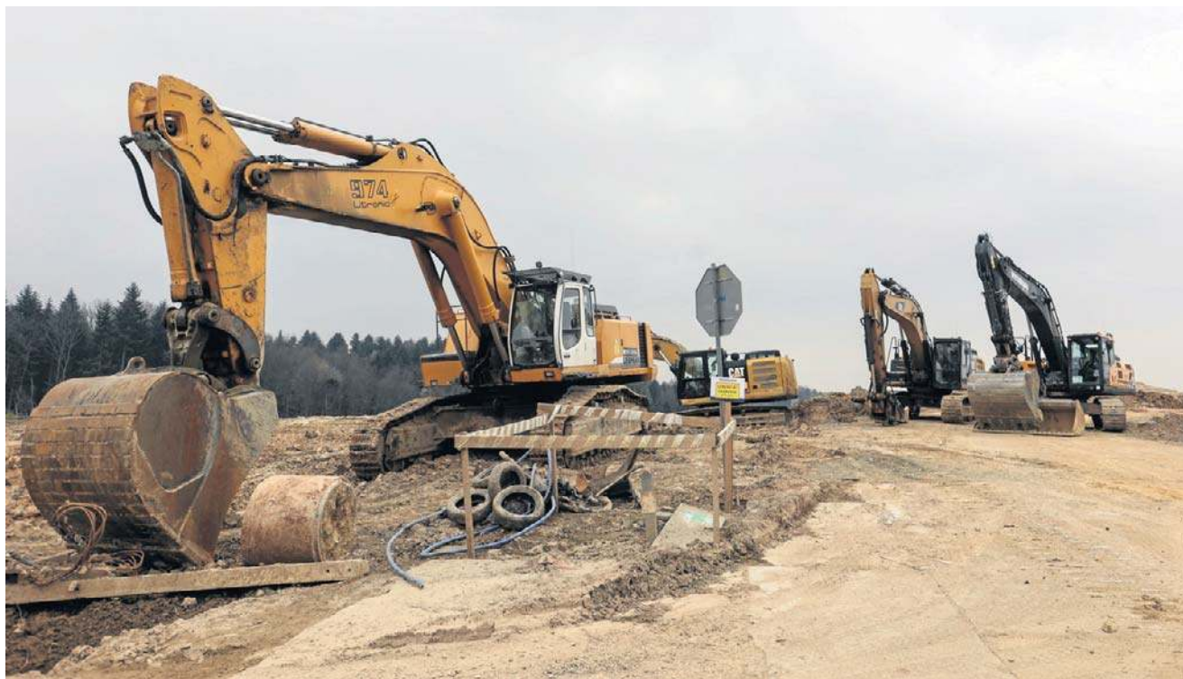
Wczoraj odwiedziliśmy plac budowy na odcinku S19 między Iskrzynią a Domaradzem. Maszyny budowlane stoją skoszarowane, a wokół nie ma żywej duszy
