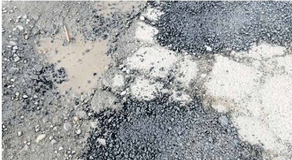
Zasypanie kruszywem wyrwy w drodze to zdaniem mieszkańca Budziwoja żaden remont
