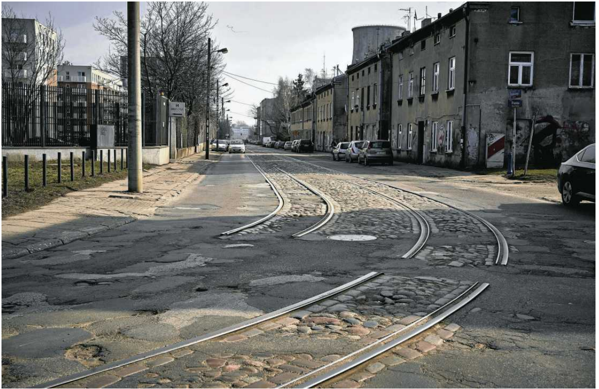
• Nierówne i popękane płyty chodnikowe stwarzają zagrożenie dla pieszych, z jezdni wystają szyny tramwajowe, a stary, wyboisty bruk od lat utrudnia życie kierowcom FOT. TOMASZ STAŃCZAK / AGENCJA WYBORCZA.PL
