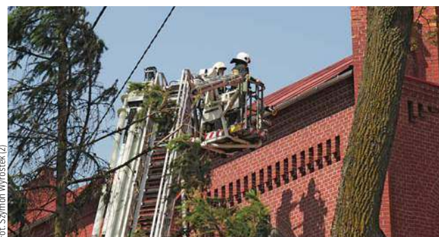
Silny wiatr poderwał dach na kościele w Wyszynach
