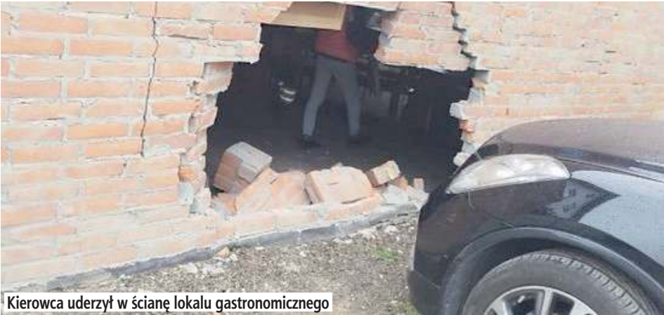
Kierowca uderzył w ścianę lokalu gastronomicznego
