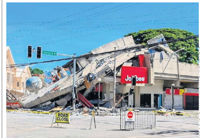
Trzęsienie ziemi nawiedziło południowe Filipiny. Uszkodzony budynek w General Santos
