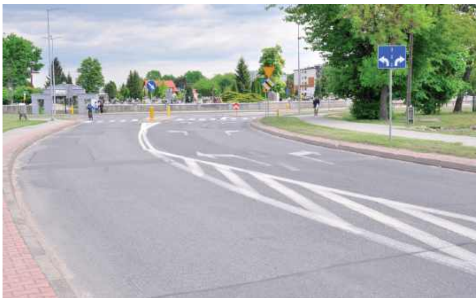
Droga zostanie dostosowana do standardów klasy GP, czyli głównej drogi ruchu przyspieszonego. Stara nawierzchnia zostanie rozebrana, a w jej miejsce powstanie nowa jezdnia o nośności 11,5 tony na oś
