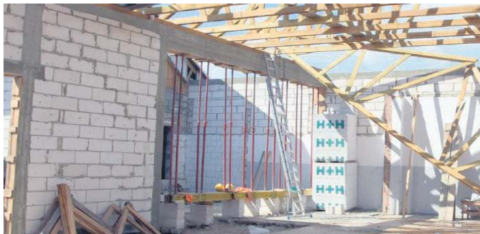
Podczas budowy garażu na terenie gminy Frampol 38-letni robotnik spadł z wysokości ponad 4 metrów.
