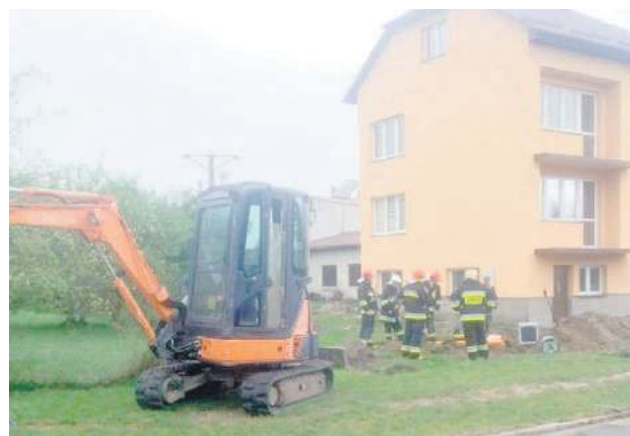
Podczas prac ziemnych operator koparki zahaczył łyżką o gazociąg i uszkodził go.
