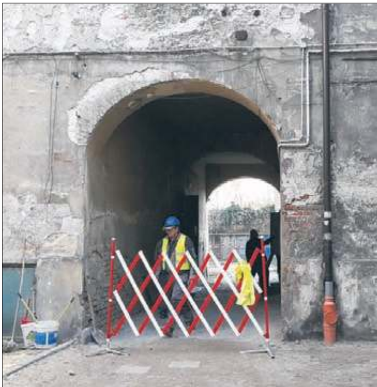
Brama oficyny przy ul. Tumskiej 14 – w ubiegłym tygodniu z budynku trzeba było ewakuować mieszkańców
