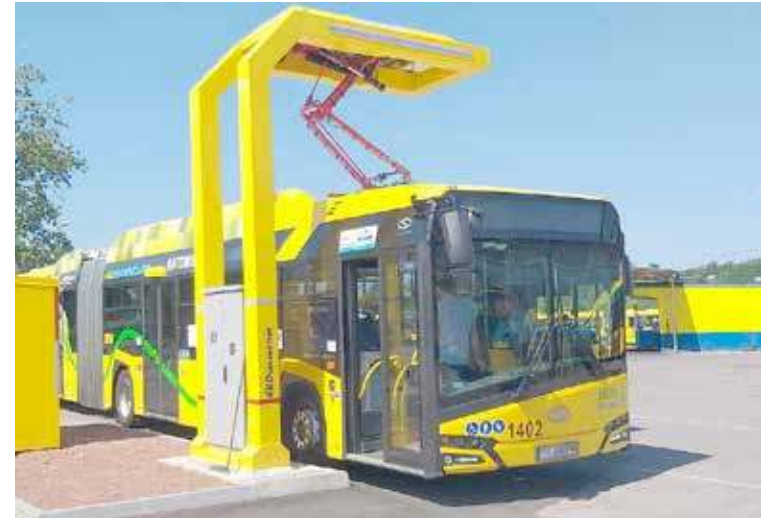
Jak wskazują specjaliści autobusy elektryczne są znacznie droższe w utrzymaniu niż spalinowe wersje
