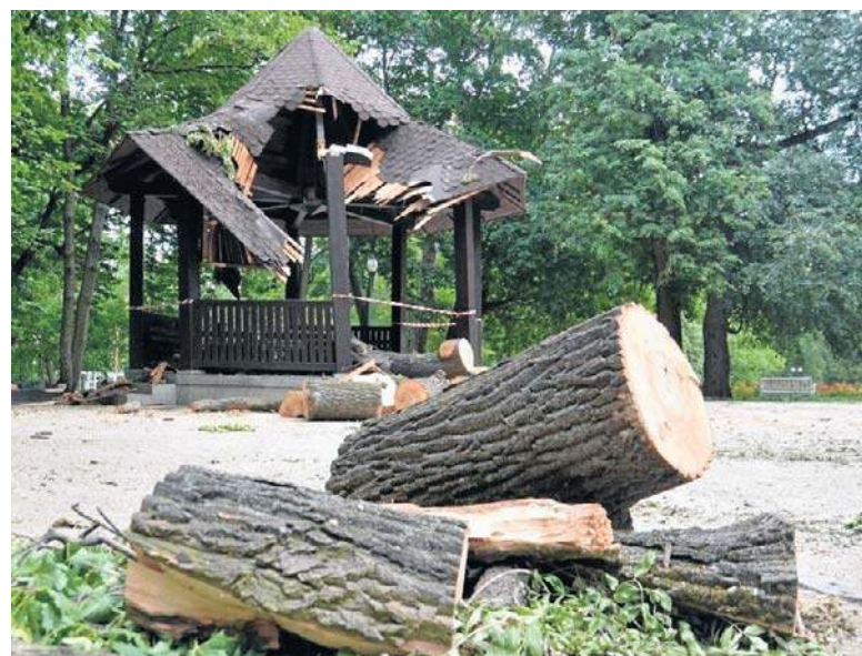
Altana została zniszczona podczas burzy w 2017 r. i od tamtej pory jej nie odbudowano
