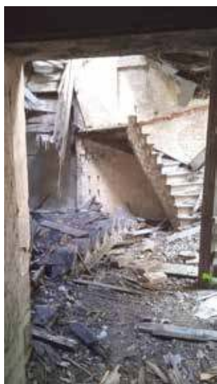
Wnętrze rezydencji - zawalone schody.
