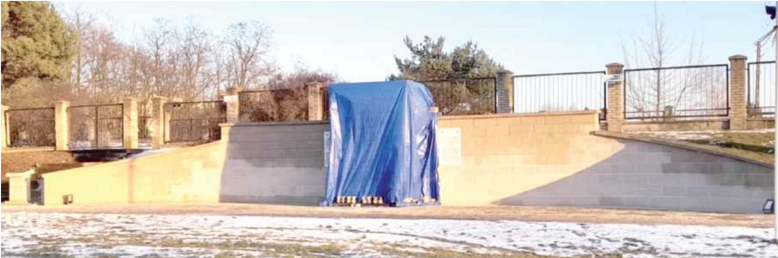
Ściana jest już w trakcie naprawy. Tak wyglądała przed weekendem
