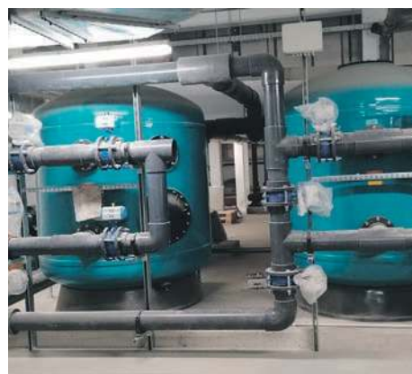
Serce pływalni, czyli widok na urządzenia w piwnicy
