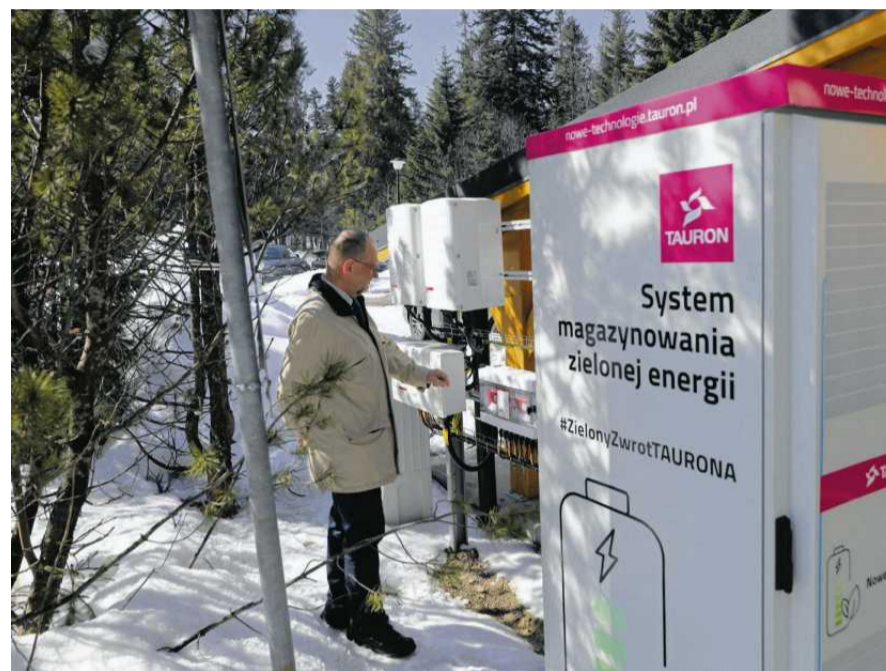
• Zakopane. Farma fotowoltaiczna z magazynem energii
