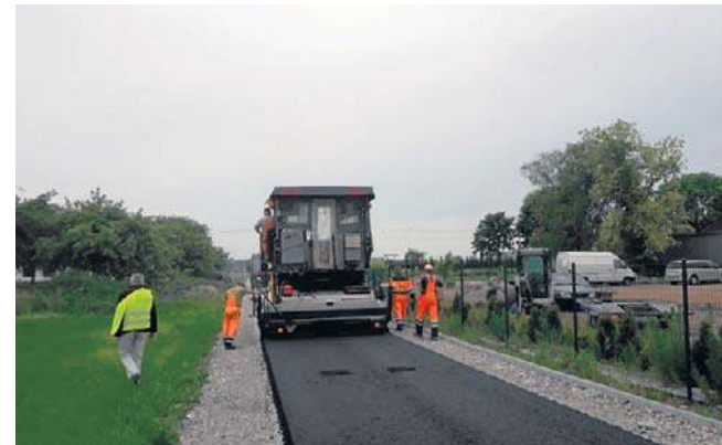
Jednym z najważniejszych zadań gmin w kolejnych latach jest finansowanie modernizacji i budowy dróg
