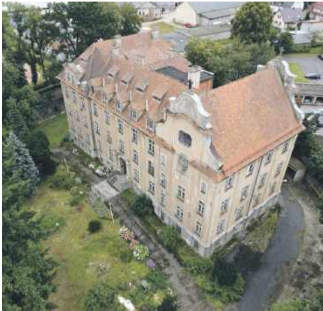
Budynek stoi i niszczeje
