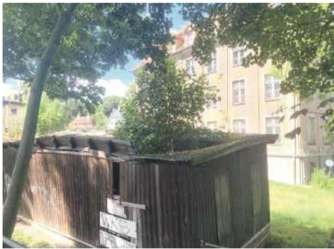
Szopa ledwo stoi, a przez dach wyrosło drzewko
