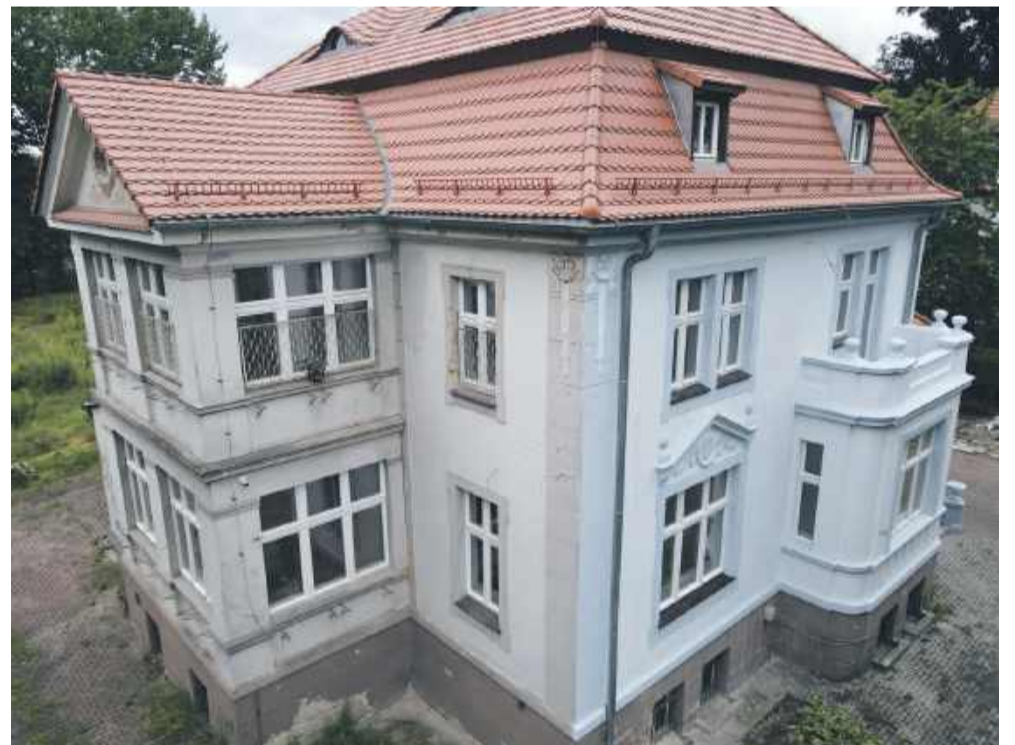
Jak widać, jedna ściana nie została wyremontowana
