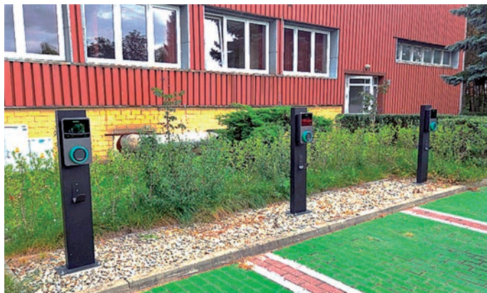
Stacje ładowania samochodów elektrycznych 3 x 22 kW
