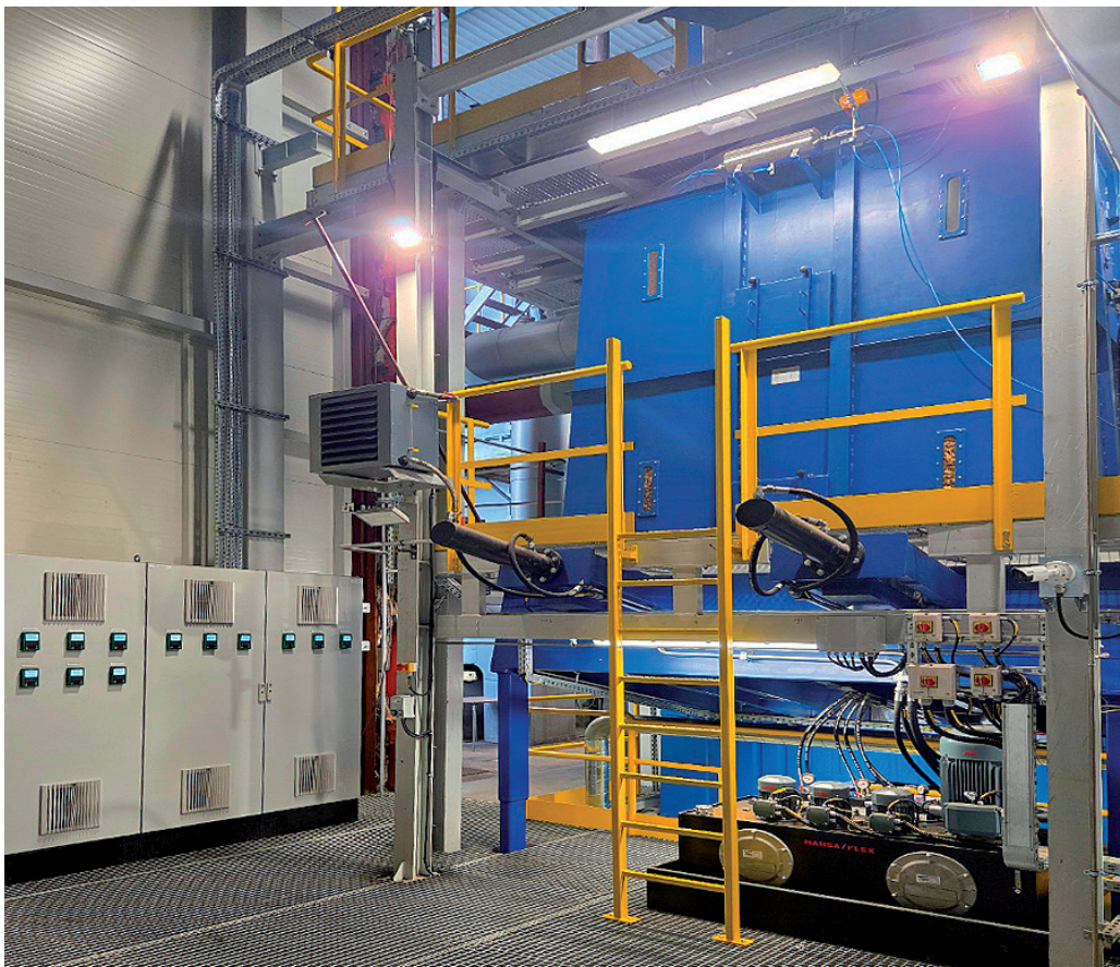
Widok ogólny instalacji kotła biomasowego KB2
