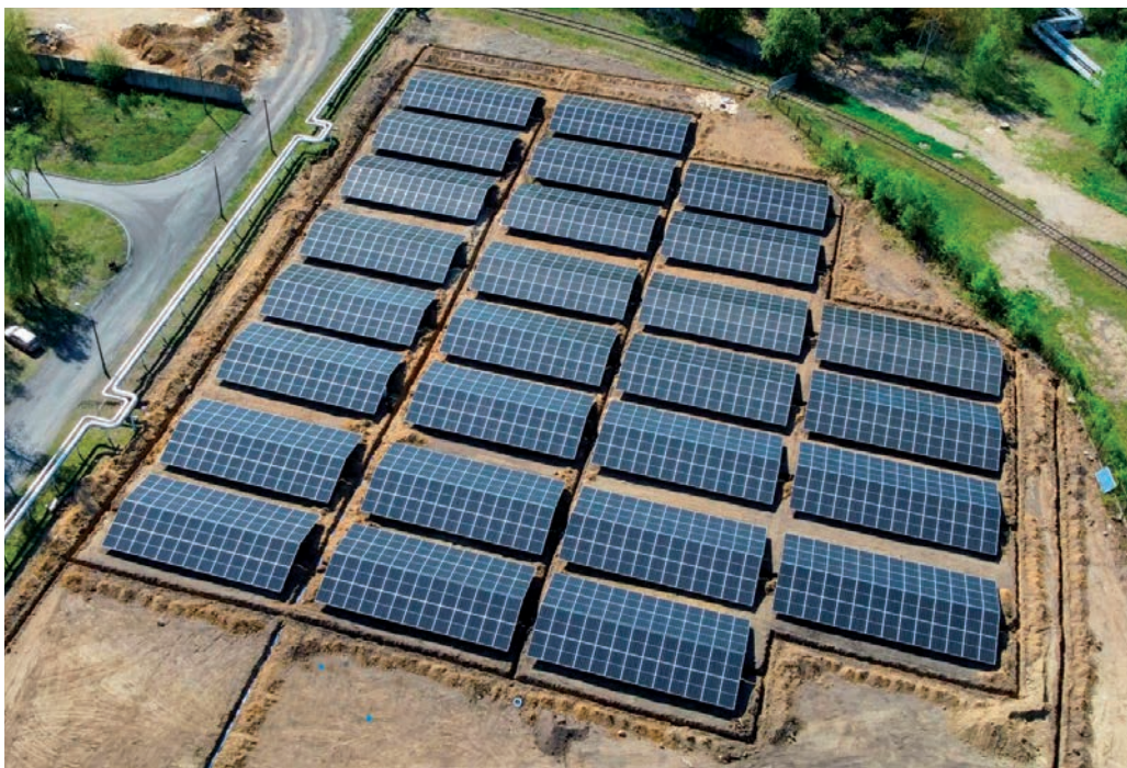
Farma fotowoltaiczna o mocy elektrycznej 0,998 MWp
