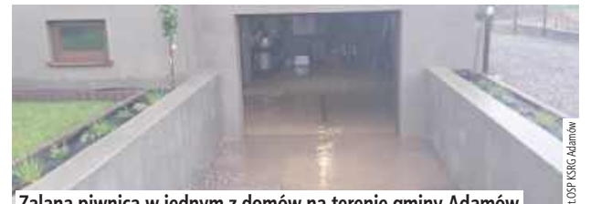
Zalana piwnica w jednym z domów na terenie gminy Adamów
