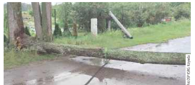
Powalone drzewo uszkodziło słup energetyczny, zrywając linię na terenie gminy Krzywda
