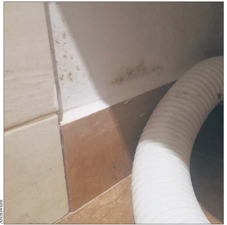
W nowiutkim mieszkaniu jest wilgoć - na ścianach, podłodze, meblach
