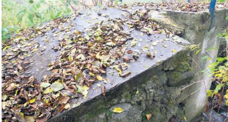
Stromy spad, jaki powstał po tąpnięciu mostu, zimą zamienia się w niebezpieczną ślizgawkę.
