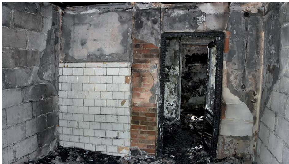
Skutki podpalenia niezamieszkałego domu
