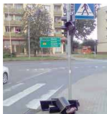
Do uszkodzenia sygnalizacji doszło pod koniec czerwca. Do dziś światła działają w trybie awaryjnym
