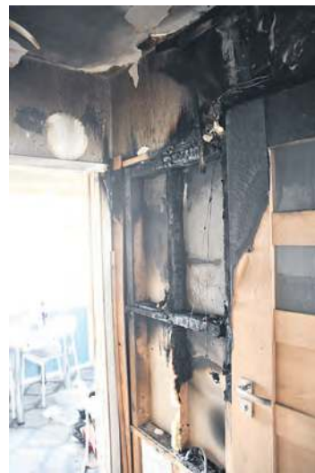
Prawdopodobny powód pożaru to zwarcie instalacji.
