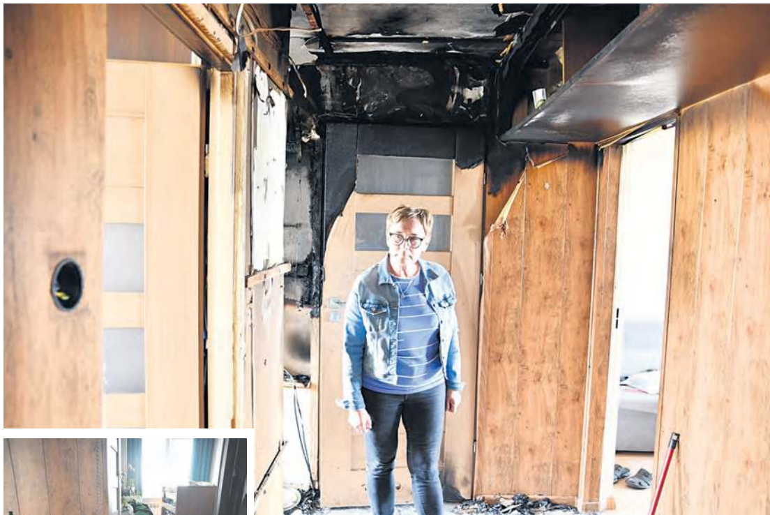
Pani Mirosława w przedpokoju mieszkania. Ogień z korytarza na szczęście nie przeniół się na pokój. Mieszkanie jednak wymaga remontu.
