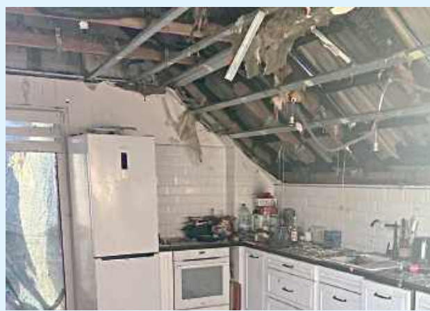
Całe poddasze budynku wymaga gruntownego remontu
