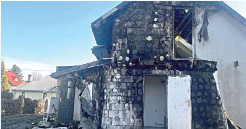
Prawdopodobną przyczyną pożaru w Wólce Wieprzeckiej było zwarcie instalacji elektrycznej
