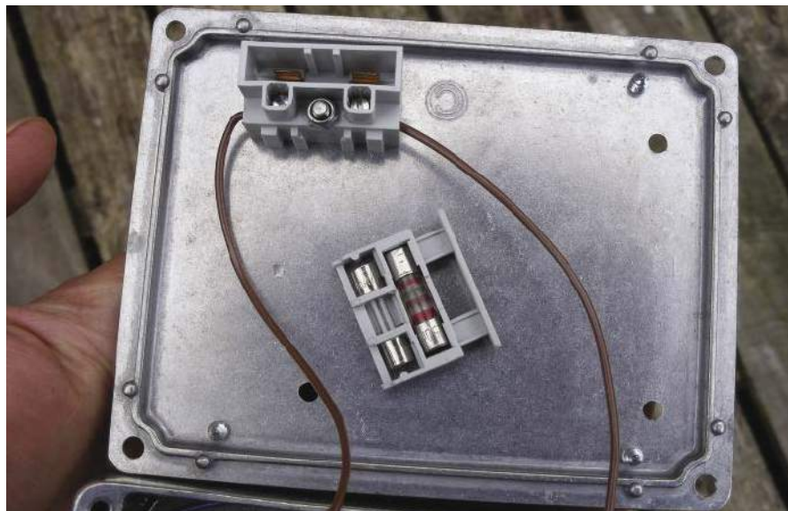
Rysunek 19. Odpowiedni wewnętrzny uchwyt bezpiecznika – jest izolowany, więc nie można ulec porażeniu. Musi być umieszczony w przewodzie fazowym (L)
