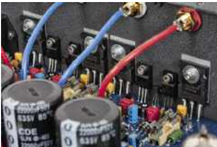
Wydaje się, że tranzystory wyjściowe (ON Semiconductor – 2 pary) przykręcono do tylnej ścianki, tymczasem na zewnątrz jest jeszcze spory radiator.
