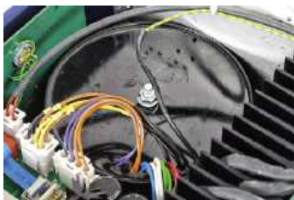
Fundamentem zasilacza jest duży transformator toroidalny.
