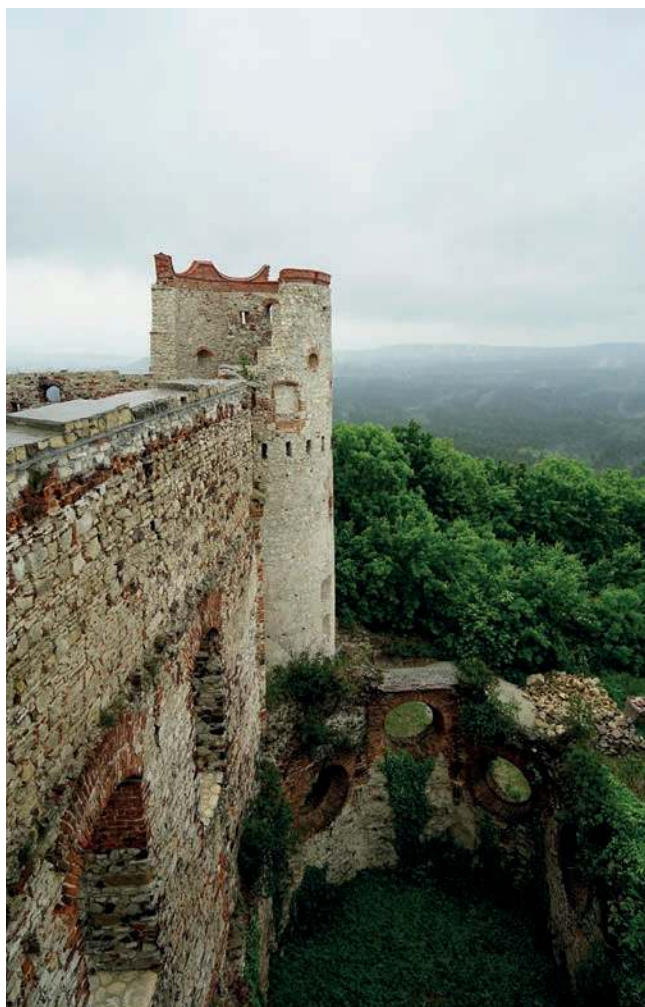
Baszta Izabela została zabezpieczona w zeszłym roku. Na ratunek czeka znajdująca się przy niej kaplica zamkowa
