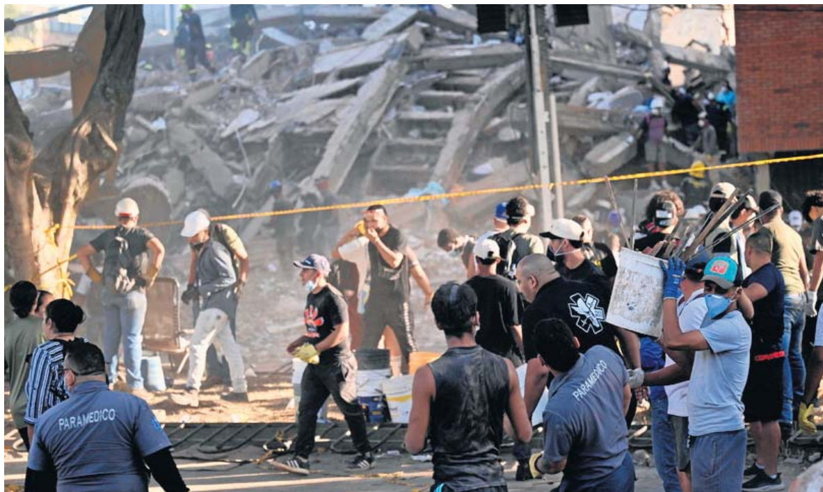
Wolontariusze i ratownicy szukają ocalałych w gruzach zawałonego budynku po trzęsieniu ziemi w Cali
