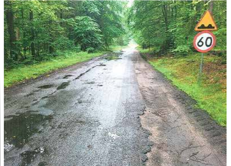
Fatalny stan nawierzchni drogi na odcinku Czermnica - Olszyca sprawia, że kierujący jeżdżą poboczem
