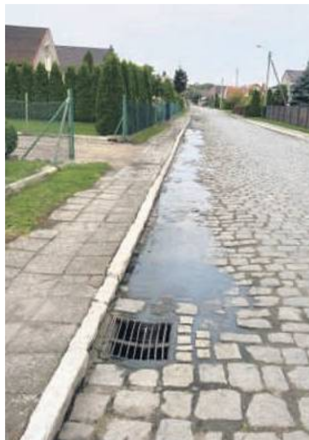
W Witowicach śmierdząca woda, przypominająca ścieki, płynie ulicą, mimo bezdeszczowej pogody. Płynie dlatego, że niedrożna jest kanalizacja deszczowa, a śmierdzi dlatego, że do tej kanalizacji prawdopodobnie podpięte są ścieki z niektórych posesji
