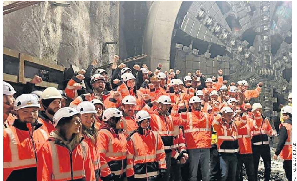
Wspaniały moment! We wtorek o godz. 19.30 tarcza „Jadwiga” przebiła się przez górski masyw. Załoga wielkiej budowy nie kryła radości. Gratulujemy!
