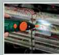
podświetlenie miejsca pracy
