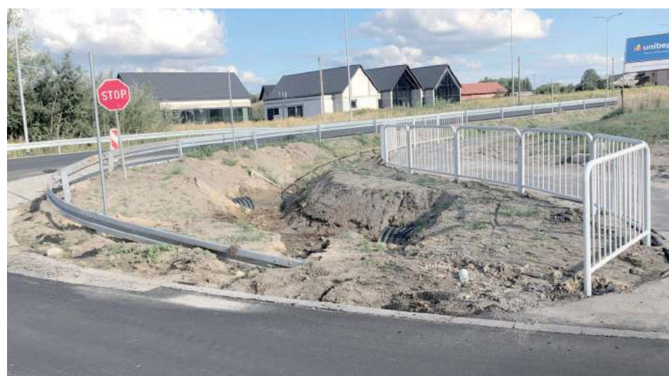
Estetyka wykończenia, ale i sposób zabezpieczenia rowu w Rogalach pozostawiają, zdaniem mieszkańców, wiele do życzenia
