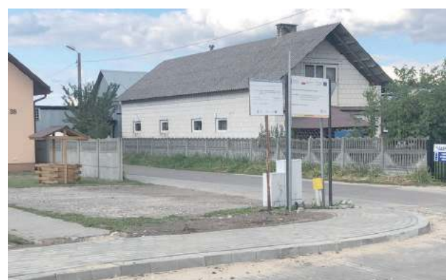
Chodnik prowadzący do skrzynek, kolejne wzniesienie chodnika na prostym terenie. - Mam nadzieję, że chociaż ten chodnik do apteki dokończą, bo póki co tylko dziura tam jest - mówi jeden z naszych rozmówców
