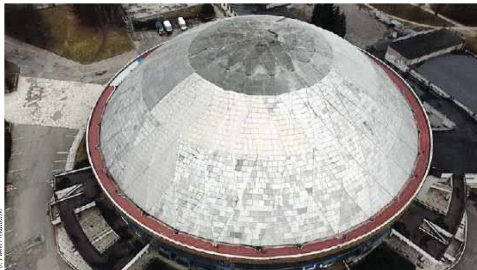
Efektowny i „szczelny inaczej” dach Uranii wielokrotnie dostarczał kibicom dodatkowych „atrakcji”
