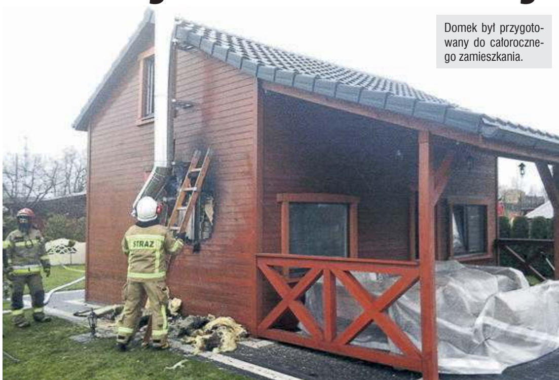
Płomienie przepaliły ścianę przy rurze pełniącą rolę komina.
