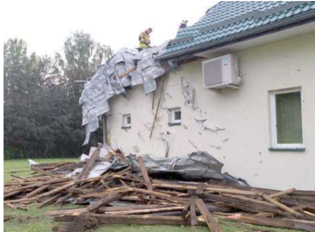
Budynek Banku Spółdzielczego, na którym wylądował dach z miejscowego kościoła
