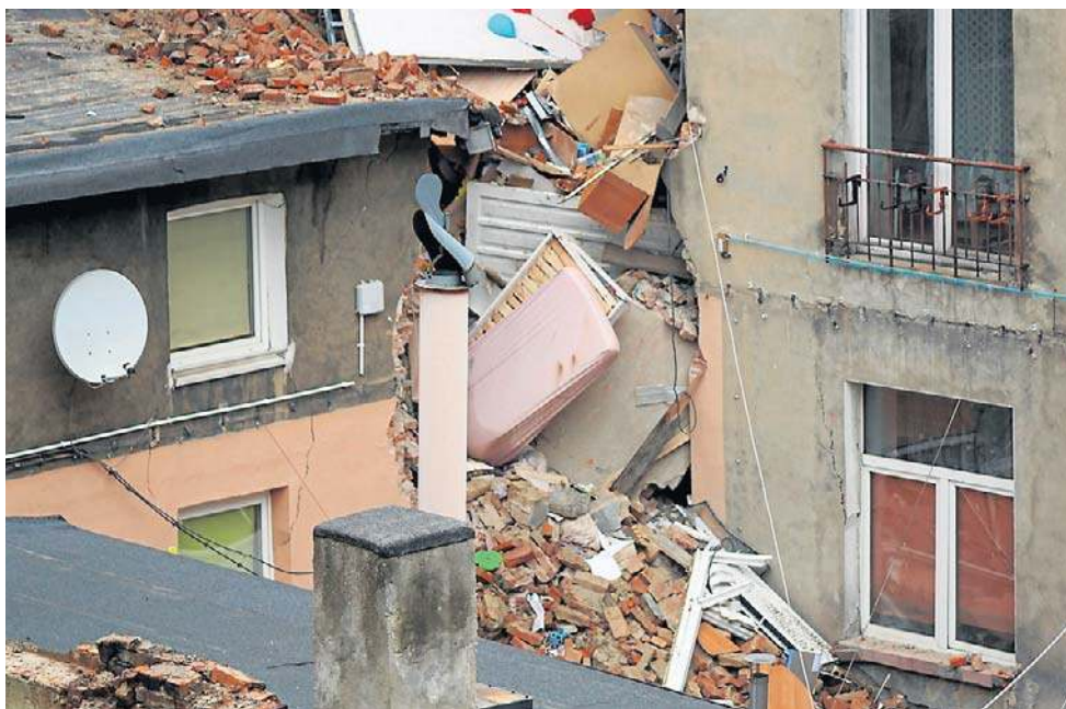
Tak wygląda oficyna przy al. 1 Maja 23. Zagrożone są sąsiadujące z nią kamienice przy ul. Próchnika. Budynki w tej części Łodzi były budowane bez odpowiednich fundamentów
