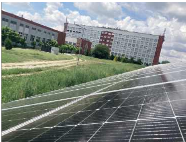
■ Panele fotowoltaiczne przy szpitalu o łącznej mocy 577,5 kW generują czystą energię elektryczną
