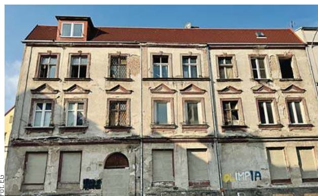
Budynek przy ulicy Czerniakowskiej 27 jest odłączony od mediów, a wszyscy lokatorzy zostali wykwaterowani
