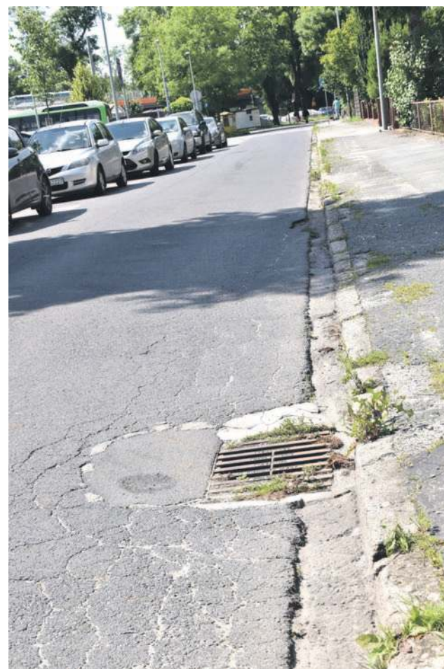
Mimo zakazu ciężarówki jeżdżą i niszczą studzienki kanalizacyjne
