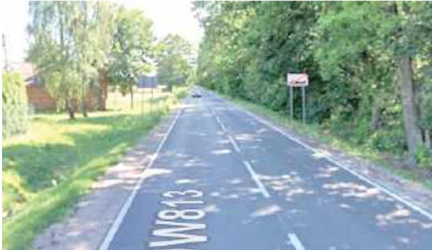
Obecnie podróżowanie rowerem przez DW-813 jest niekomfortowe. Cykliści są wyprzedzani przez szybko jeżdżące samochody
