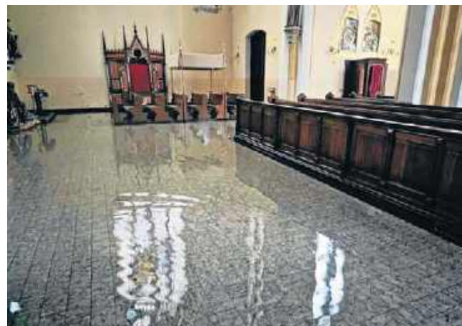
Cała świątynia była zalana, ściany przemoknięte
