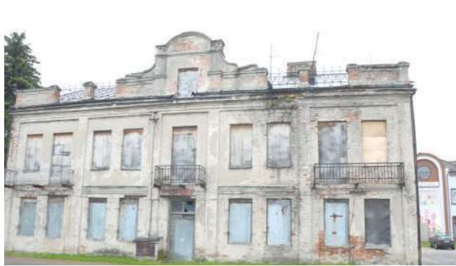
Budynek przy Urzędzie Miasta w Radzynie po ostatnim pożarze został zabezpieczony, nie można do niego wchodzić. Wybudowany w 1936 roku, jako jeden z nielicznych w mieście (może jedyny), nosi na elewacji ślady kul z czasów II wojny światowej
