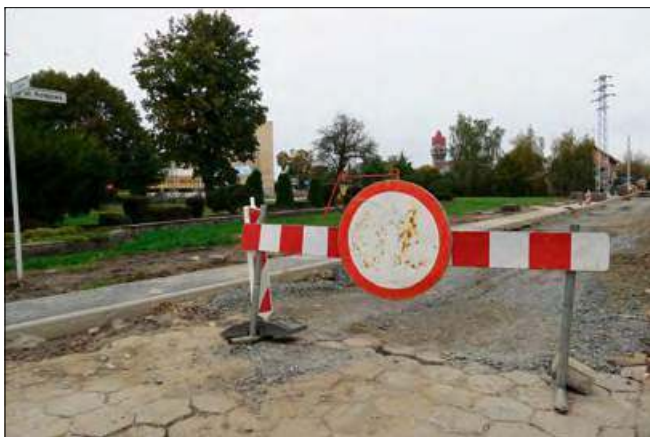
Była trelinka, będzie asfalt - ale gdzie jest odwodnienie?
