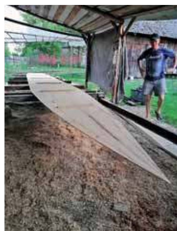
Łódź budowana była od podstaw
