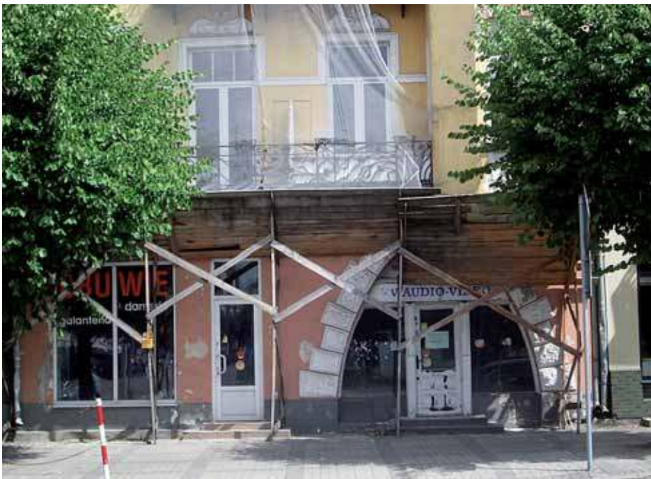
Przez zabezpieczające rusztowanie i ochronne siatki czasami spadają na chodnik drobne kawałki elewacji
