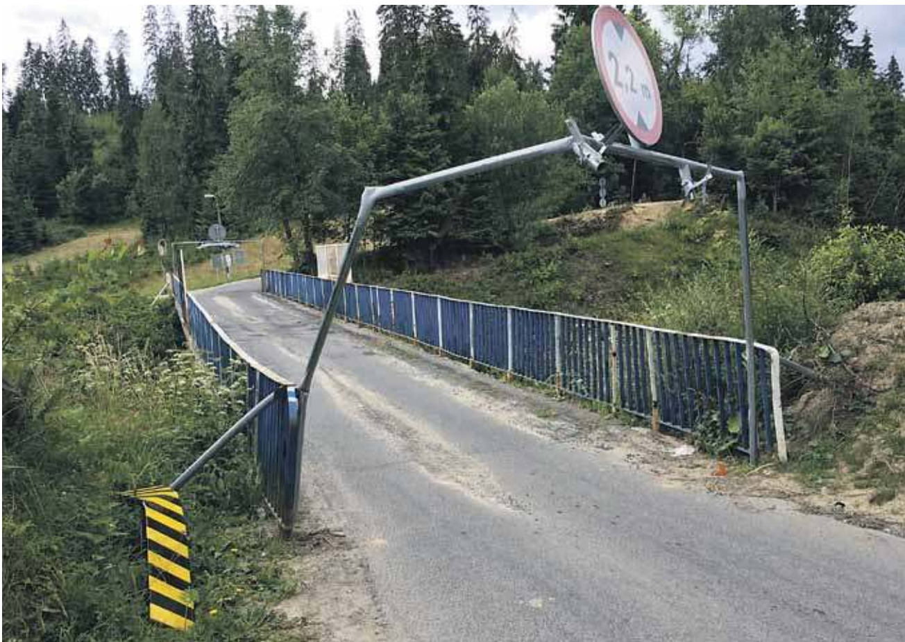
Zniszczone oznakowanie na wiadukcie w Pyzówce.
