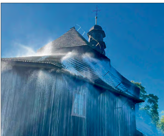
Zabytkowy, drewniany kościół św. Rocha w Dobrzeniu Wielkim zyskał nowoczesny system przeciwpożarowy, który w razie zagrożenia automatycznie uruchamia zraszanie dachu.
