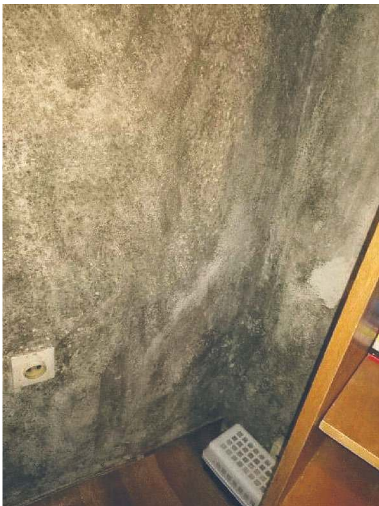
Zagrzybione ściany mieszkań przy Sienkiewicza 11
