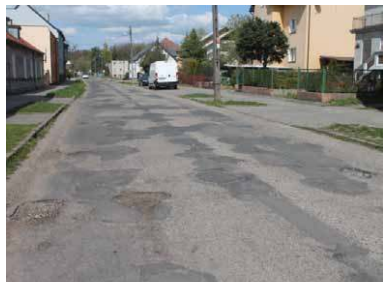
Takie dziury, że trudno przejechać w obu kierunkach znajdują się na Wiejskiej
