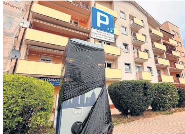
Część urządzeń została wyłączona z bieżącego użytkowania.
